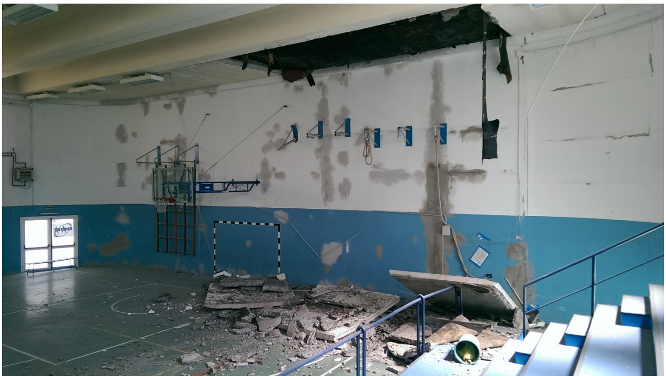
Fig.6: particolare del pannello di copertura crollato.
