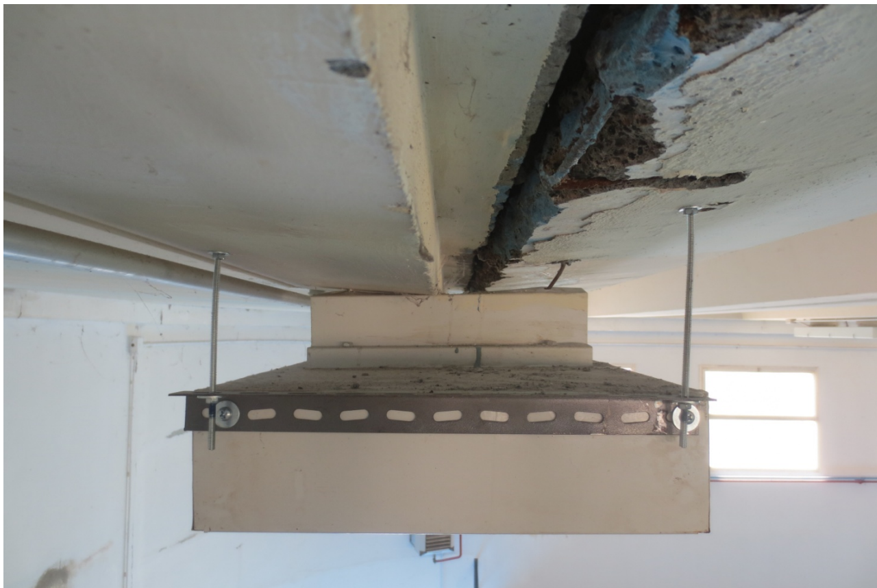
Fig.3: particolare dell'innesto dei corpi illuminanti sulle intersezioni dei tegoloni di copertura.
