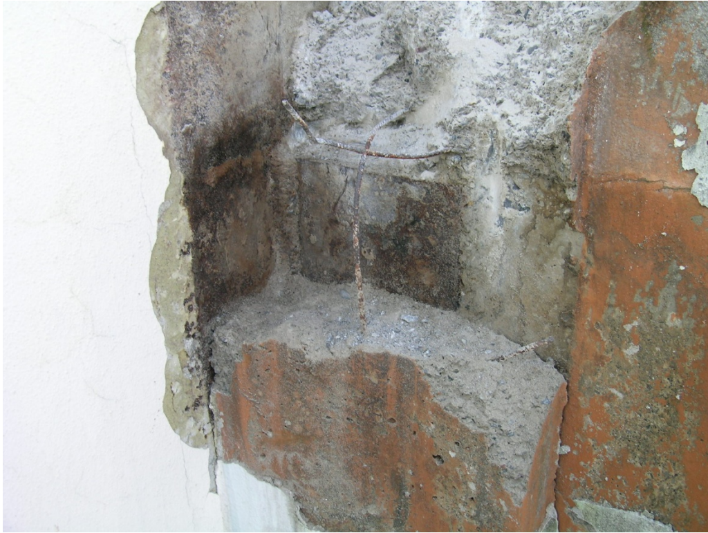
Fig.5: particolare dell'attacco tra colonna esterna e trave ad L di copertura con lamiere ossidate
